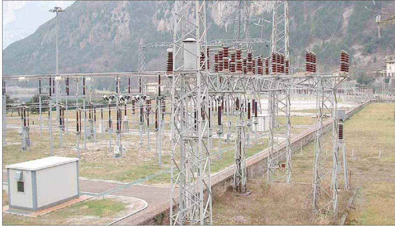
La centrale idroelettrica di Santa Massenza, considerata tra le più strategiche in Trentino
